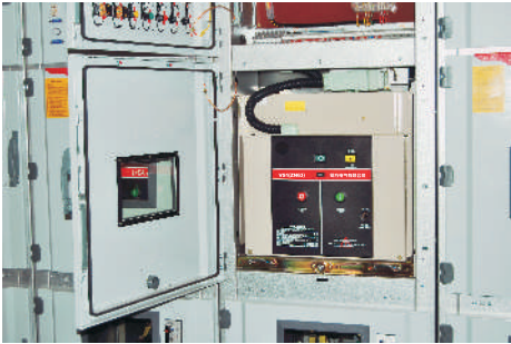
主断路器室 Main circuit breaker room
