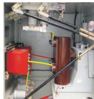
断路器室 Circuit breaker room
