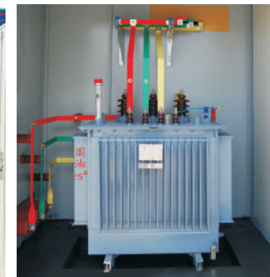
变压器室 Transformer room
