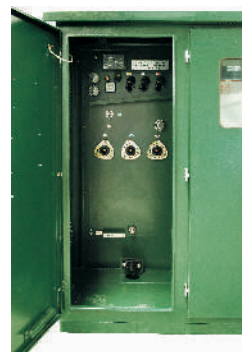
高压室 High pressure chamber
